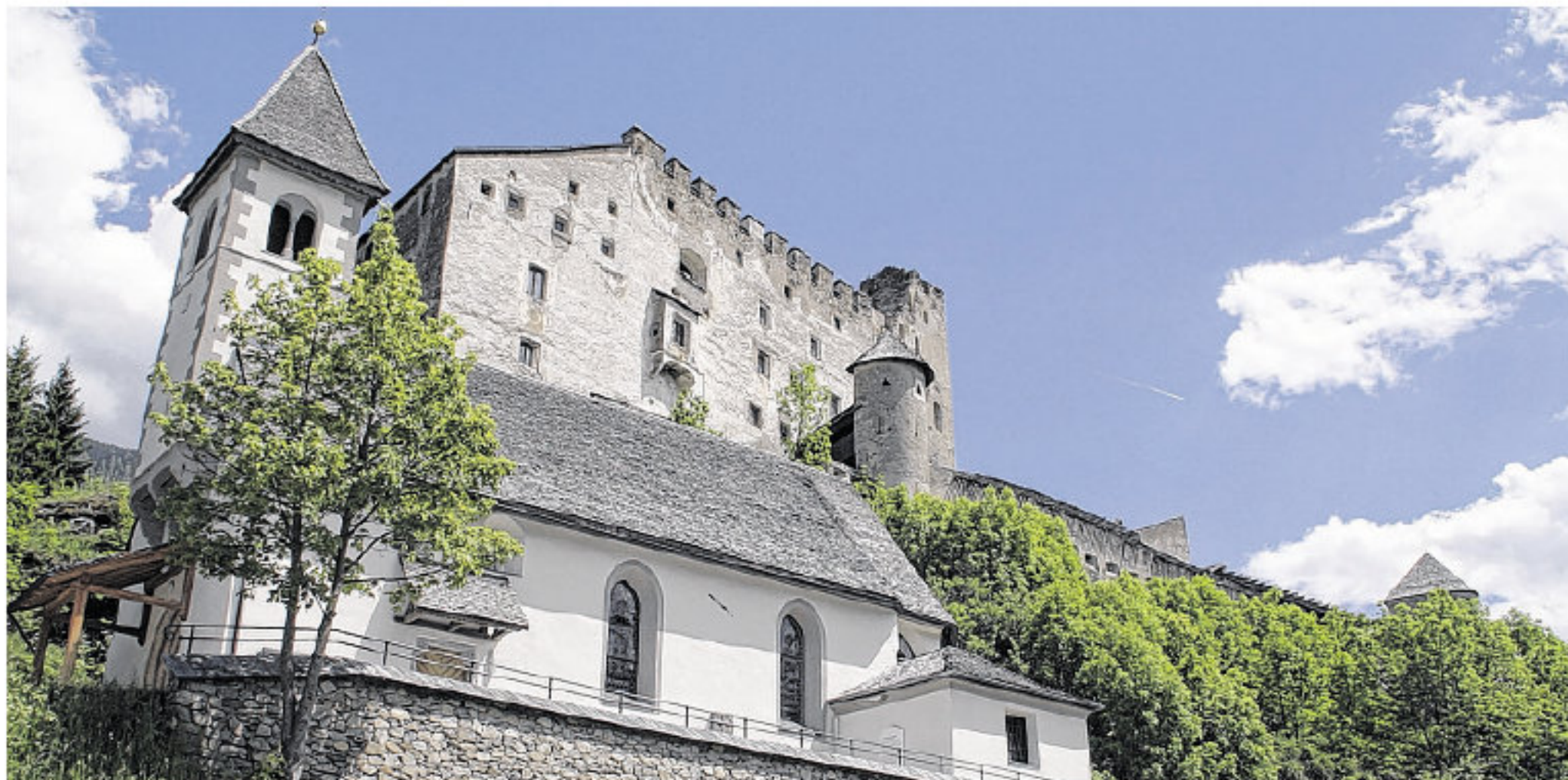
Zurzeit ist die Burg Heinfels noch baufällig, immer wieder brechen Mauerstücke ab. Mit der Sanierung soll sich das ändern.
